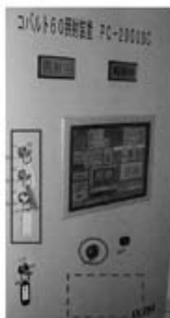
図5 インターロックキー非常用停止スイッチ（盤）バックアップ電源
