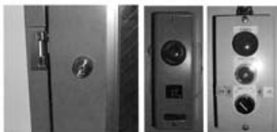
図6 照射室出入口扉 図7 【左】 非常停止スイッチ 【右】 緊急脱出スイッチ 安全スイッチ
