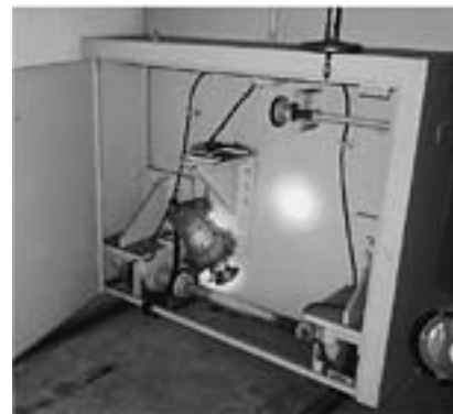
図4 損壊した遮へい扉駆動部 (1階分析電磁石室)
